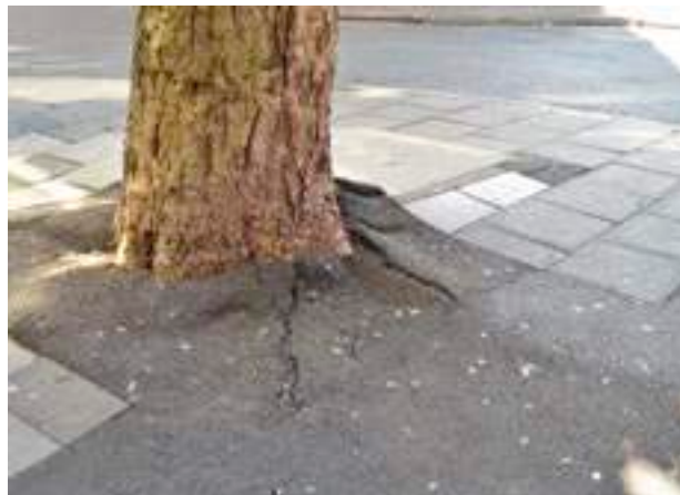
Voorbeeld van hoe een boom met de wortels de verharding omhoog drukt
