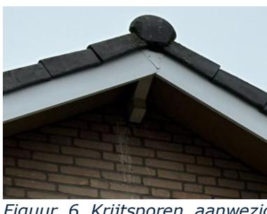
Figuur 6 Krijtsporen aanwezig bij woning in Spoorstraat.
